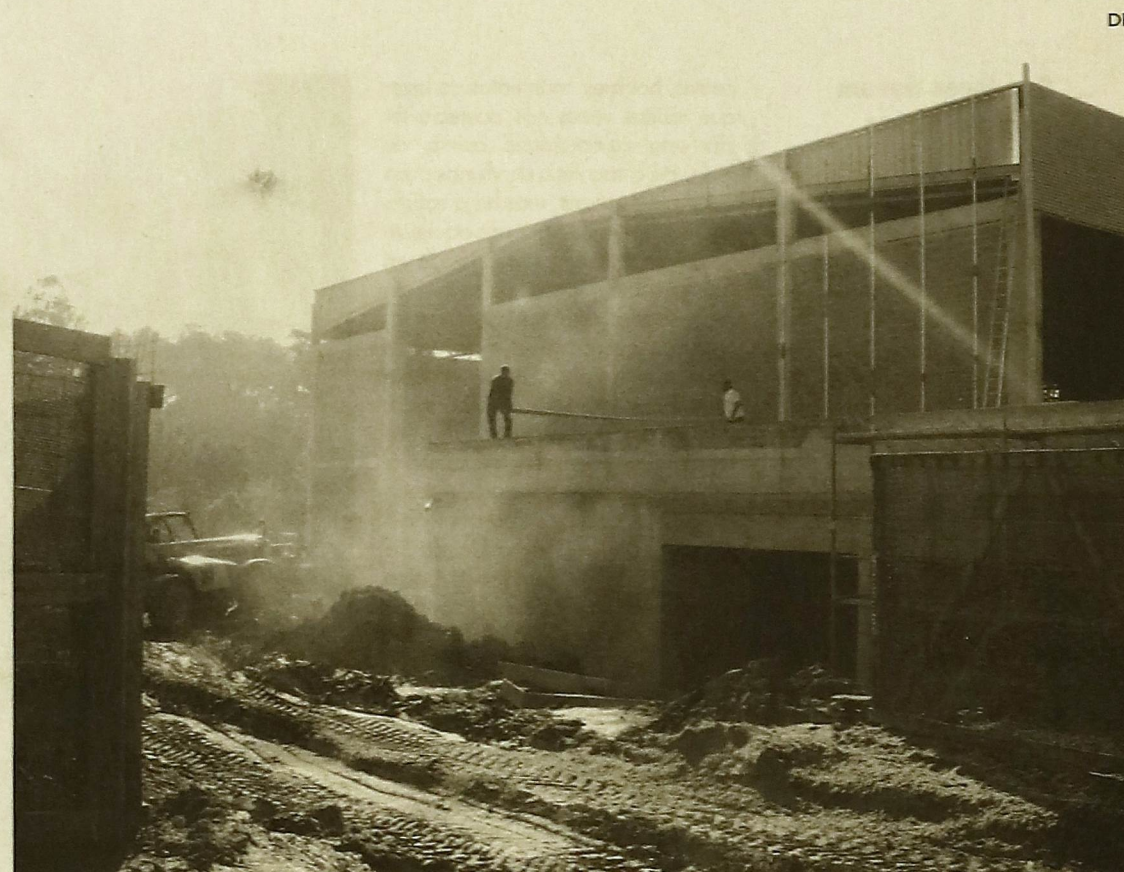
O novo pavilhão municipal sedeado em Anta começa a ter a estrutura erguida
