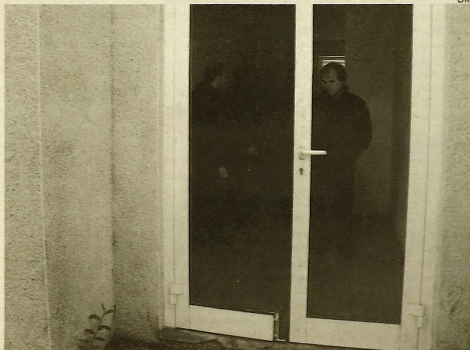
A degradação no complexo habitacional da Quinta de Paramos é bem visível
