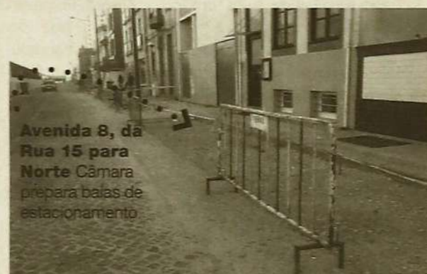
Passeio da Rua 18 com a Rua 35 piso muito danificado
