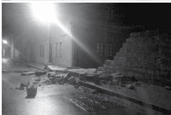
Muro na rua 4 entre a 33 e 31 cedeu ao mau tempo
