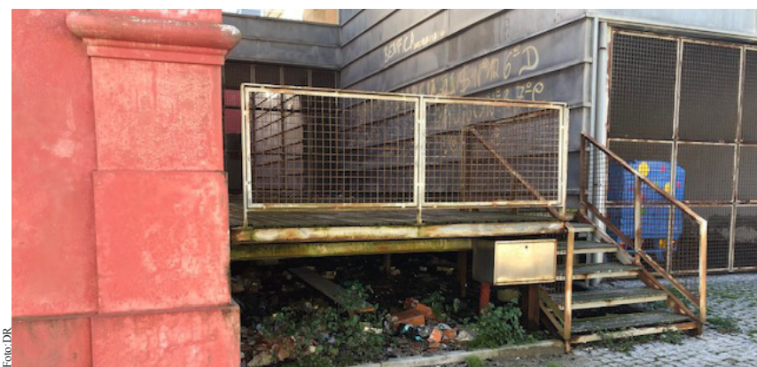
Há zonas do FACE que estão completamente degradadas.
