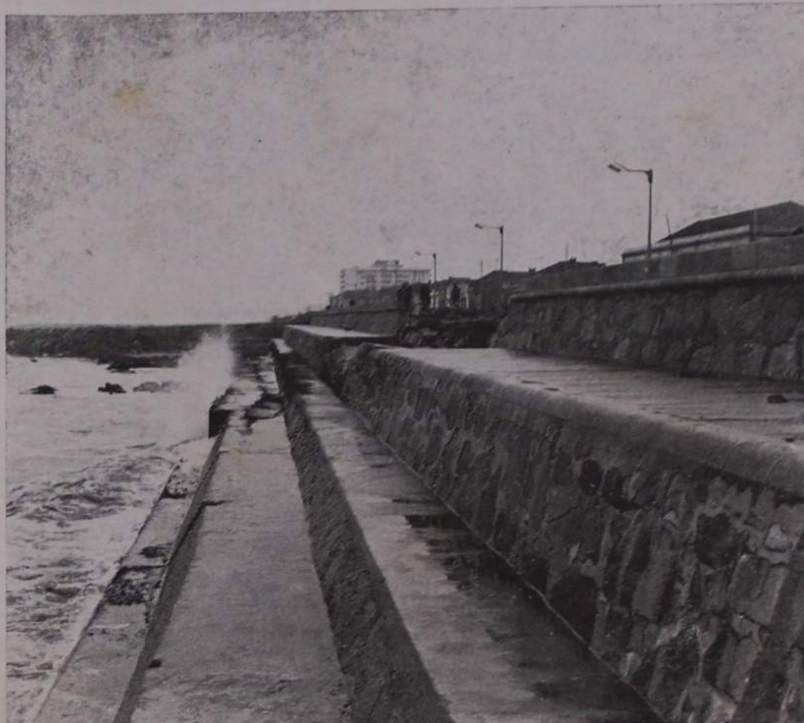
Aspecto da Defesa Frontal da nossa Praia, com a «bocarra» aberta, frente ao Posto da Guarda Fiscal, que nesta foto, por defeito da perspectiva, não é dada na sua desoladora extensão. Exemplo evidente duma destruição que só foi possível pela falta de assistência e vigiância, pois o mar «aproveitou» uma brecha já existente no fim da época balnear. Que sirva como ameaça e aviso.
