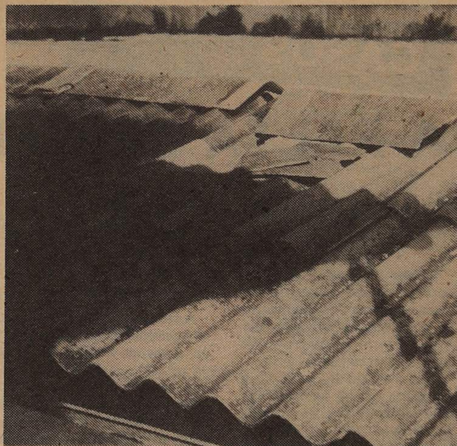
Telhados a cair ...
