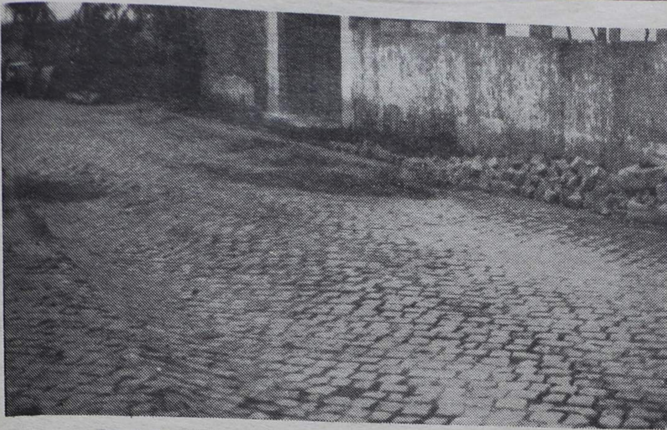
Rua do Quartel, há anos nesta situação. Melhor dizendo, cada vez pior...
