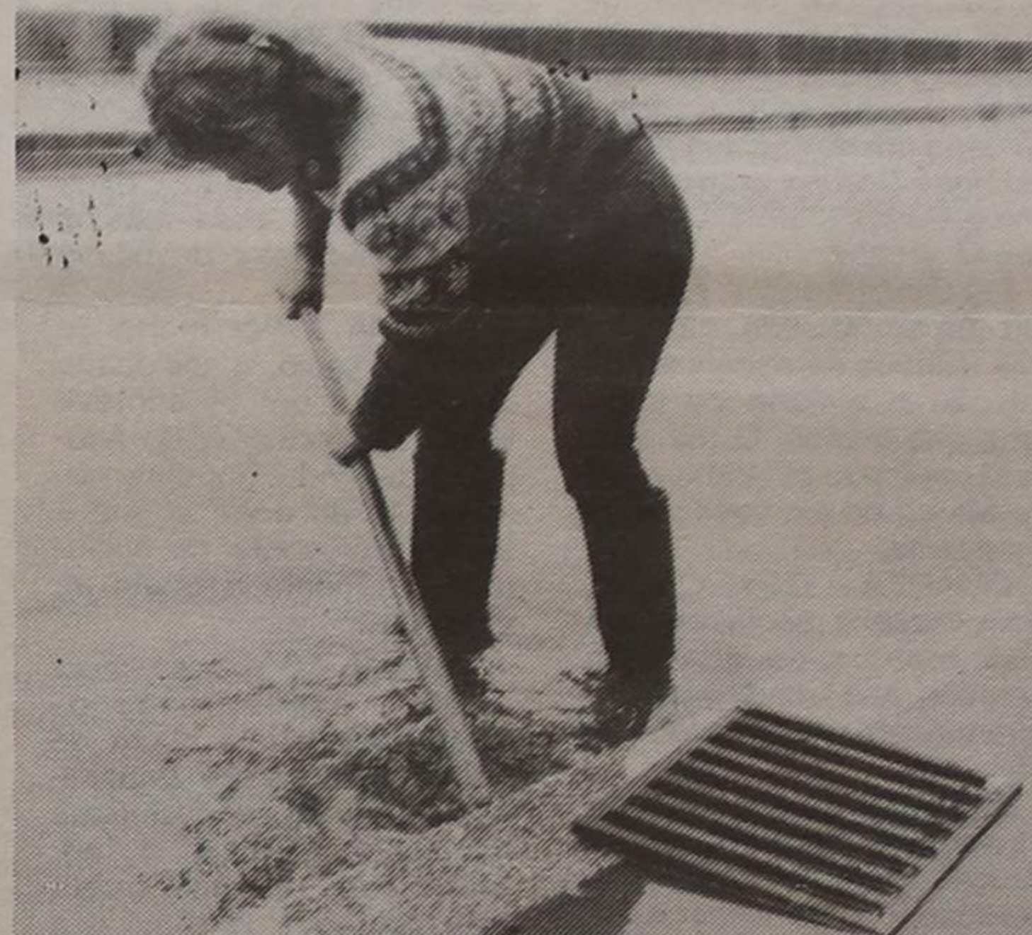
Sarjetas entupidas, em parte devido à falta de uma fiscalização implacável — opina Luís da Rocha e Carmo, da secção de saneamento básico dos Serviços Municipalizados
