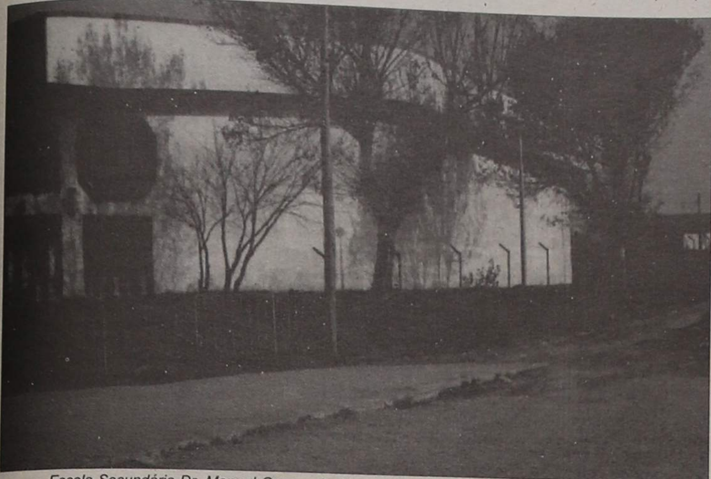
Escola Secundária Dr. Manuel Gomes de Almeida: rede da vedação bastante danificada.
