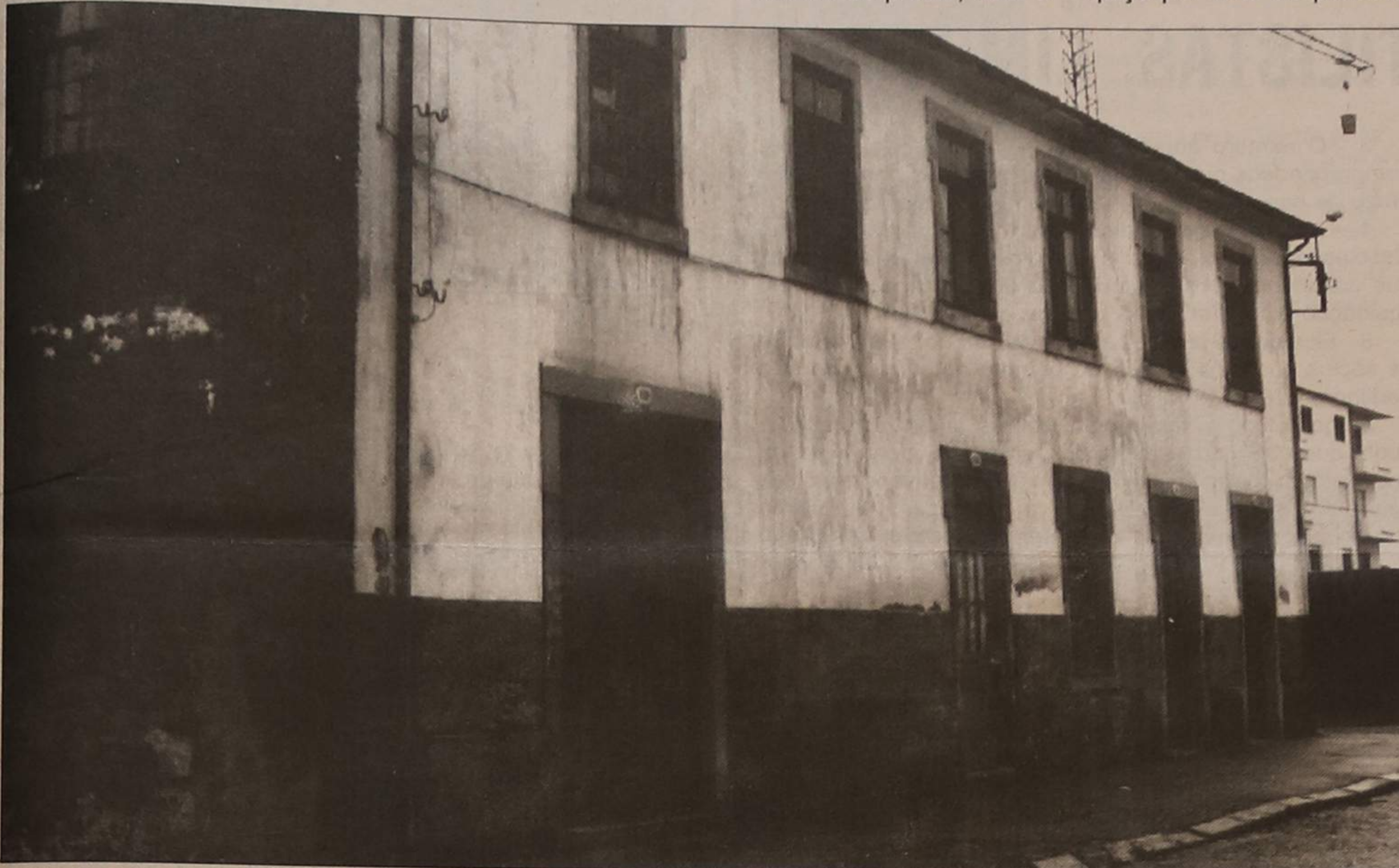
A juntar à negligente degradação do prédio, as janelas foram abertas e os vidros partidos, para além do telhado, que também não foi poupado...
