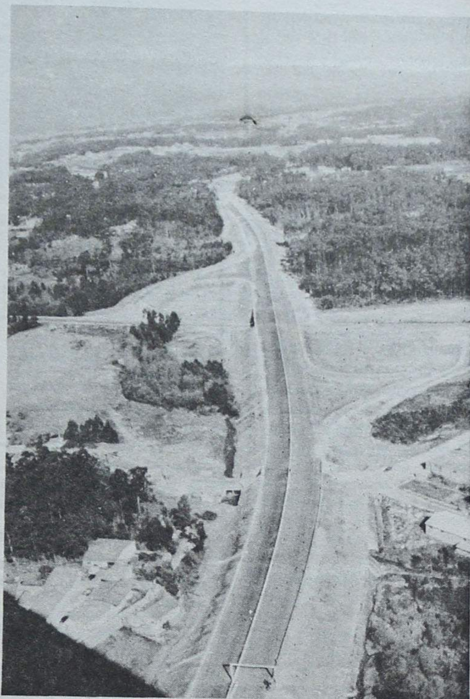
"Construção do IC1 acarretou estragos muito consideráveis nos arruamentos"
