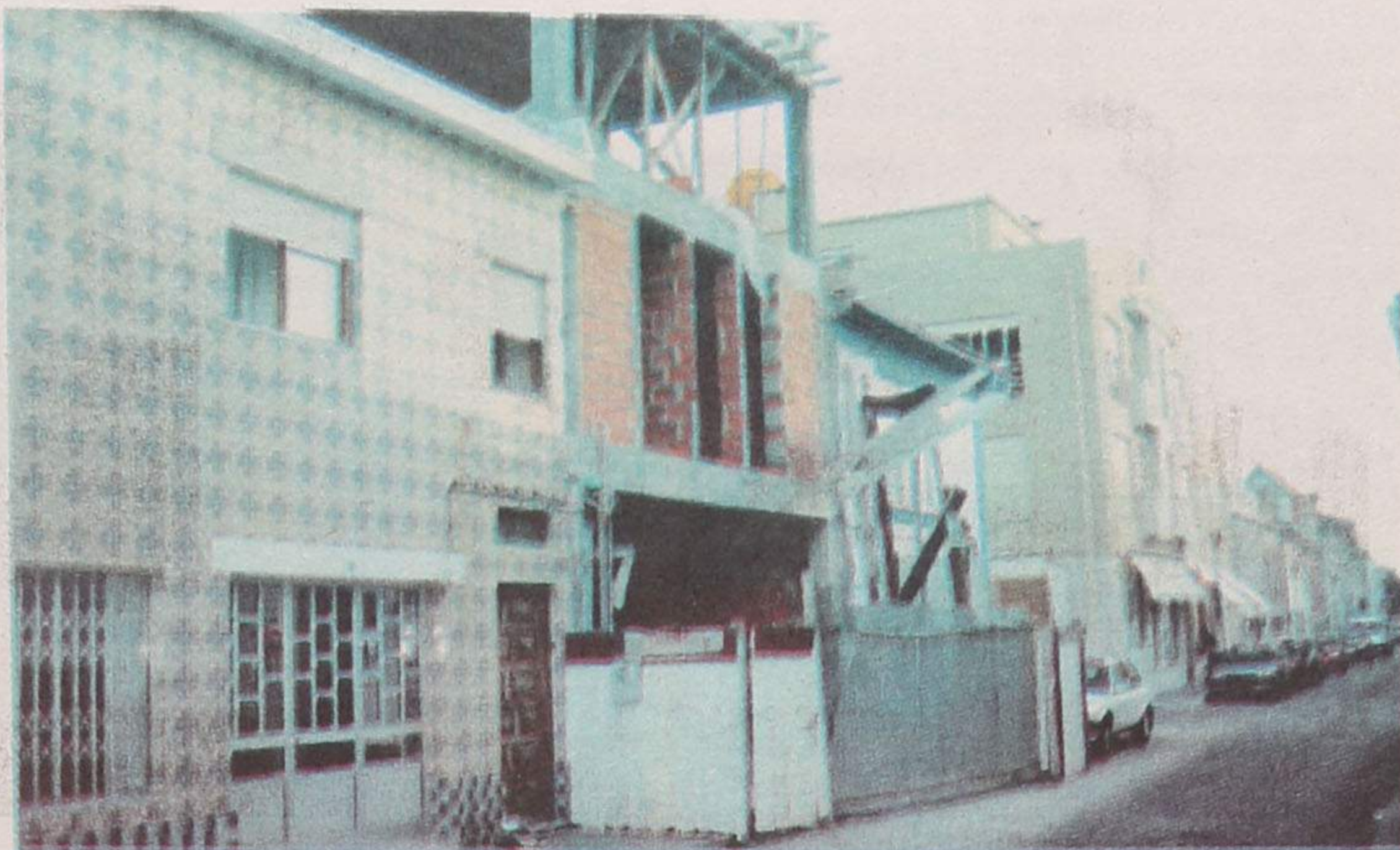
O empreiteiro garante não ter dinheiro para acabar o prédio
