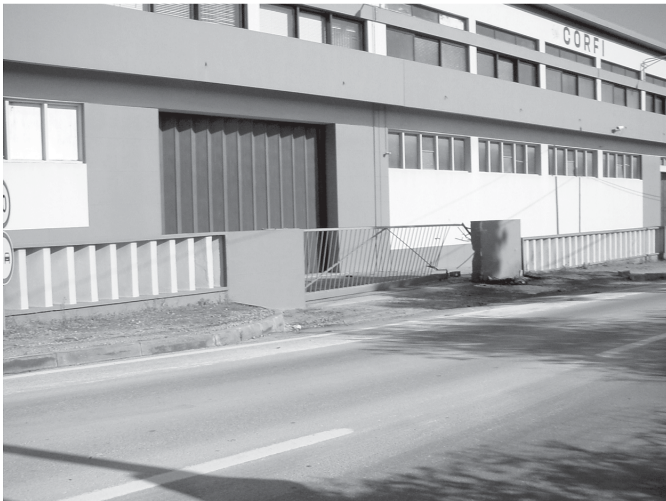
São visíveis os estragos provocados pelo embate no portão e muro da Corfi
