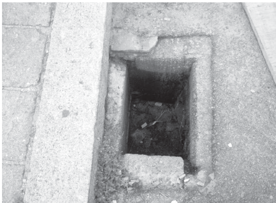
Buraco junto ao Hospital
