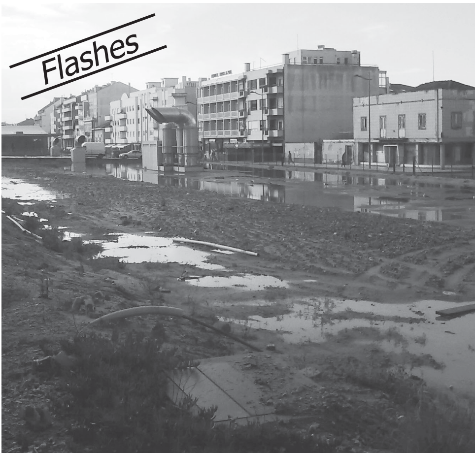
As águas da chuva acumulam-se sobre a placa superior do túnel da via-ferrea
