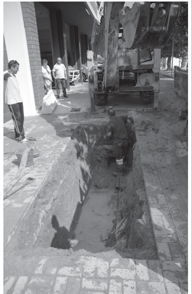
A rede de saneamento básico causou (na manhã de domingo) novo buraco: agora na Rua 16 (junto aos Bombeiros Voluntários de Espinho)
