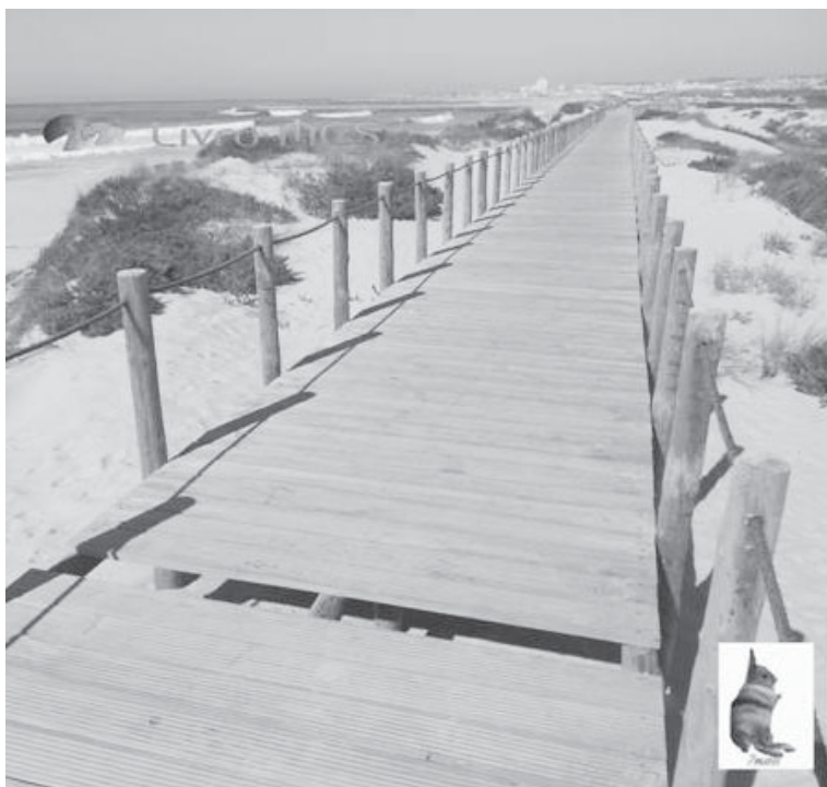
Já desapareceu uma tábuia do recentemente estreado passadiço de Paramos
