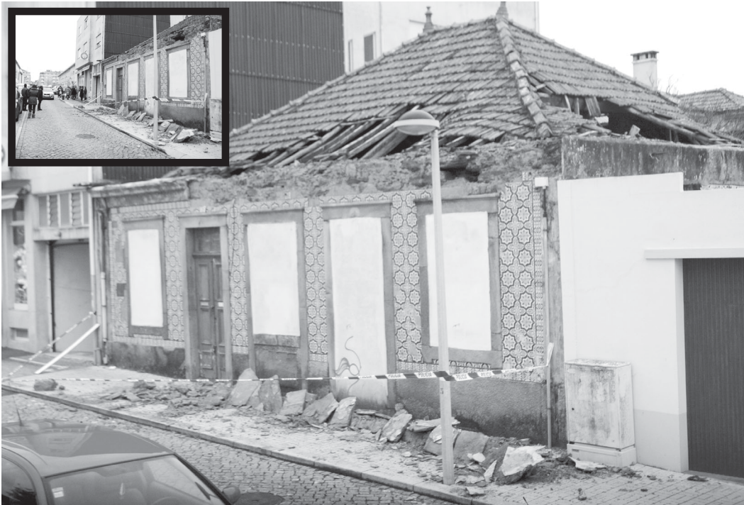
Beiral cai num passeio da Rua 29 (e o telhado vai-se desmoronando)
