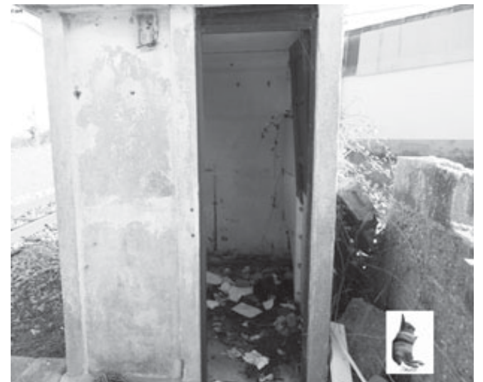
O estado da casa da guarda da Linha do Vouga em Espinho
