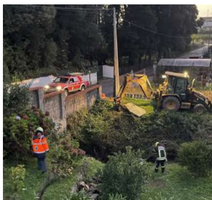
Queda de estrutura em Anta obrigou ao corte da estrada
