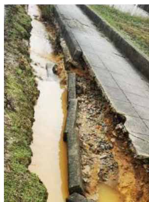
Estrada de Santiago, em Silvalde, acabou parcialmente destruída
