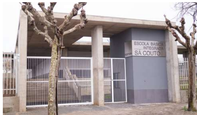
Obra na Escola Sá Couto não está terminada devido a problemas de infiltração de água.
