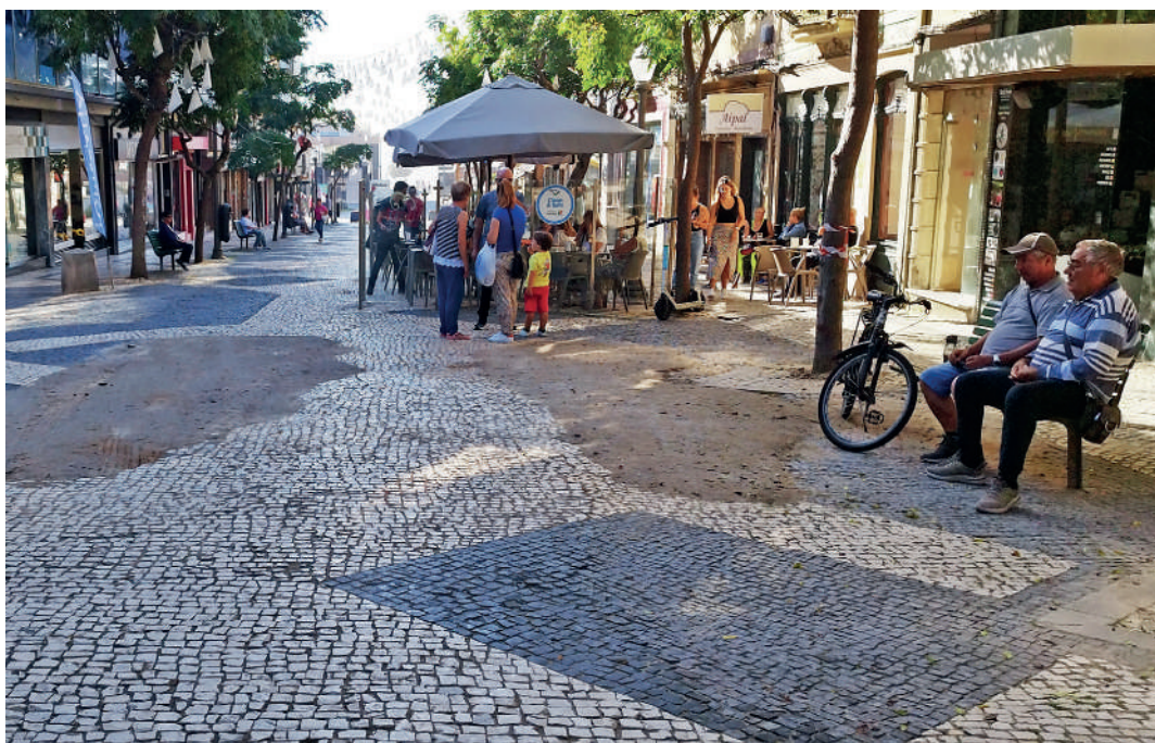
Na rua 19 são muitos os buracos e a irregularidade do piso provocados pelos rebentamentos das condutas de água.
