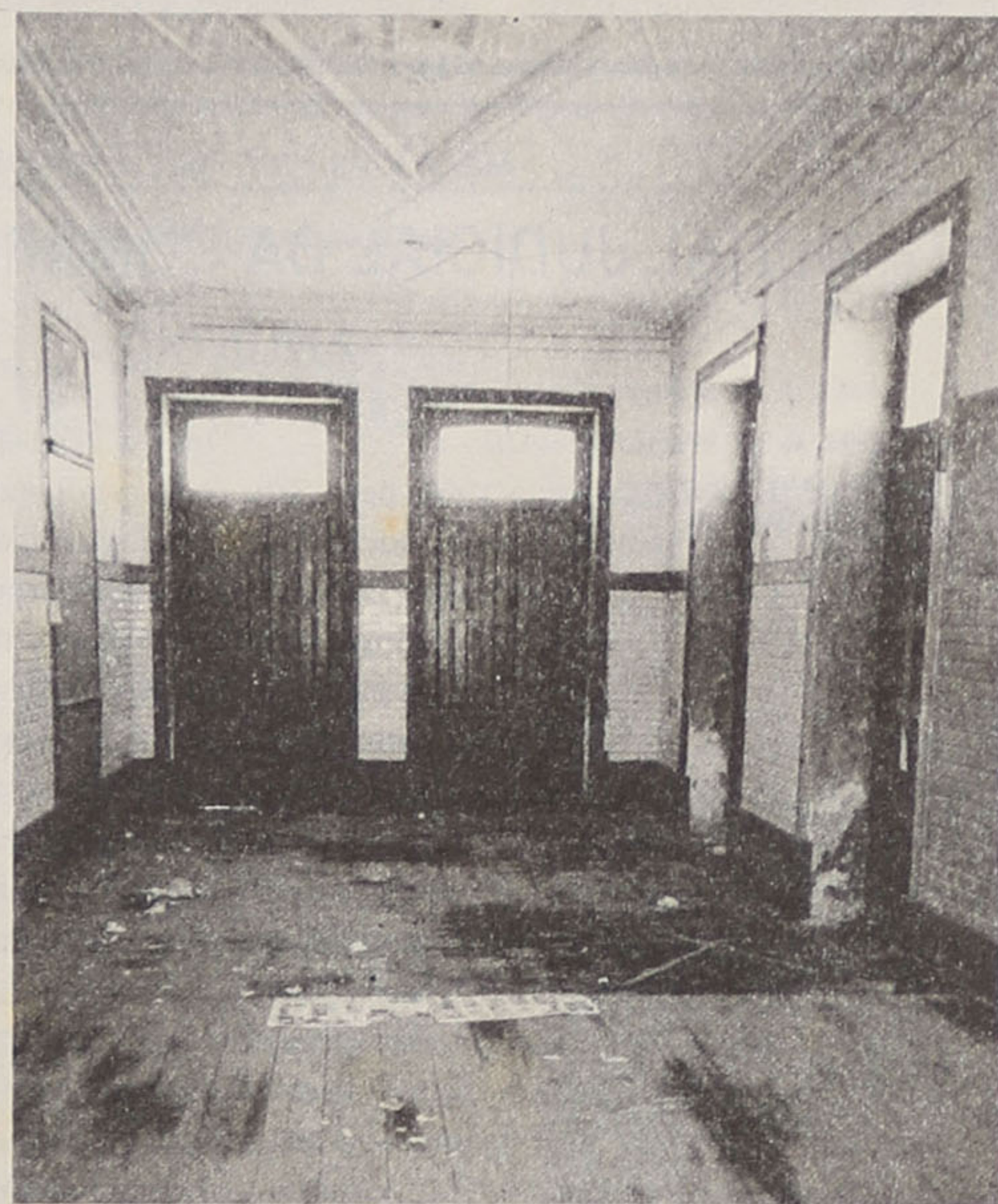
As casas abandonadas, e em condições de salubridade e segurança lamentáveis, foram objecto de preocupação. Como por exemplo, o edifício sito na esquina das ruas 14 e 29, devassado e transformado em lixeira.
