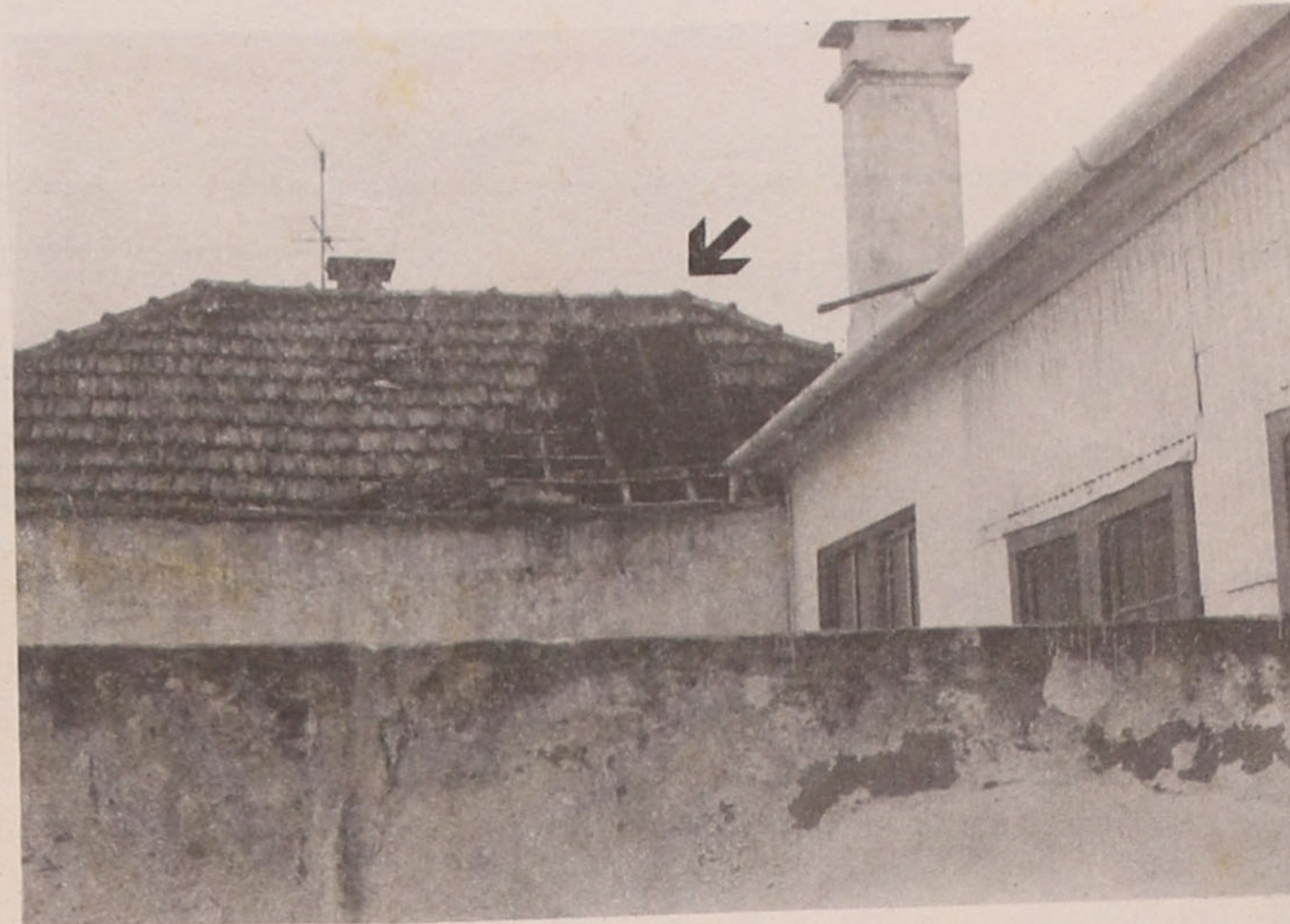
As chamas chegaram até ao telhado (parte norte da residência)
