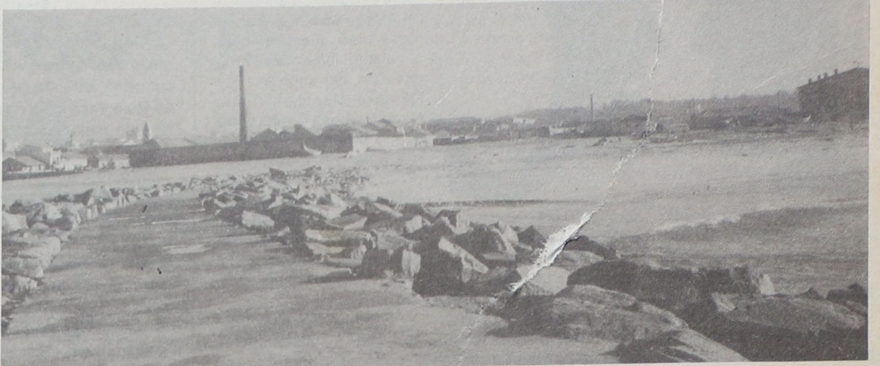
As cabeças dos esporões não são recondiçionadas há dois anos e a defesa da praia está em questão
